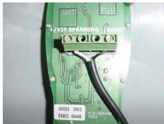
Bild 1.19 Elkabelns spår genom kåpan
